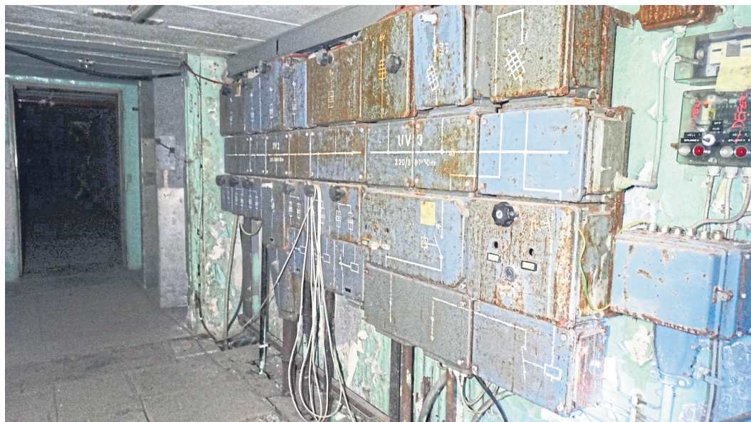
Kabelsalat im NATO-Bunker in Kindsbach.
